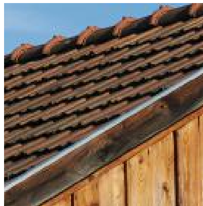
bontott tetőcserep és faburkolat
